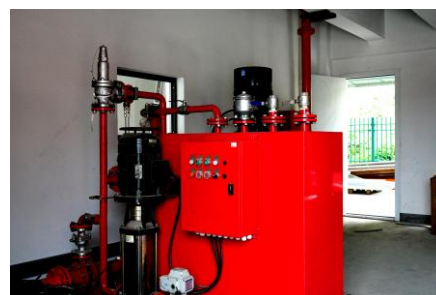
水泵控制箱 Pump Control Box
