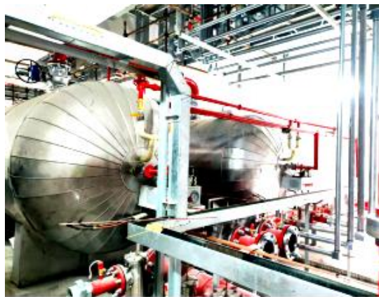
二氧化碳储罐 CO 2 Storage Tank
